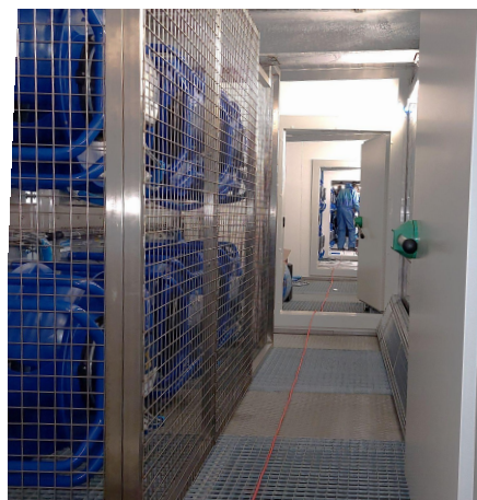
Système de ventilation pour refroidissement
